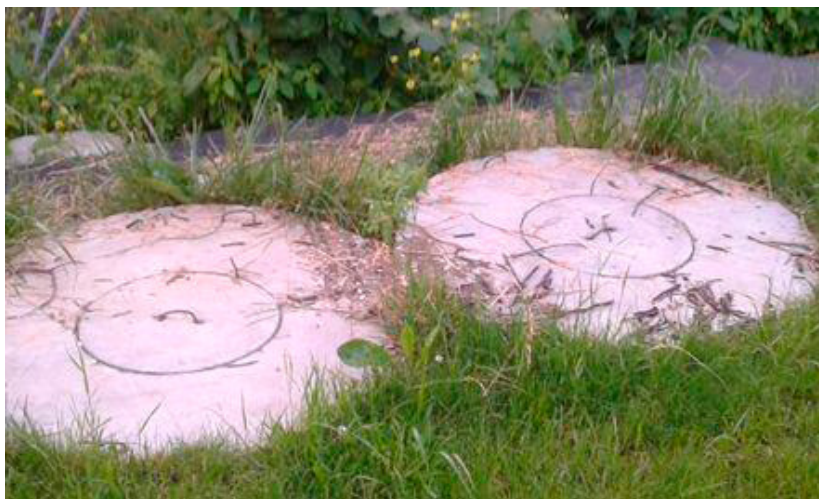
Dwie studnie szczelne do gromadzenia wody opadowej przykryte betonowymi pokrywami (fot. K. Rosiek)
