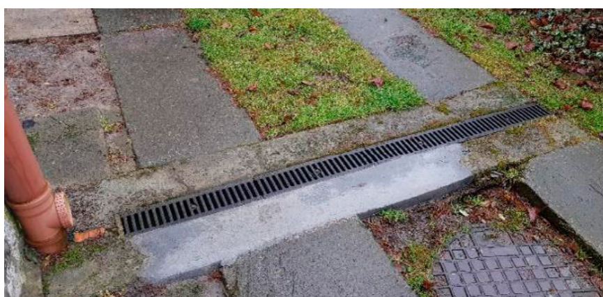
Inny sposób odprowadzenia wody z rynny na trawnik (fot. M. Siudak)
