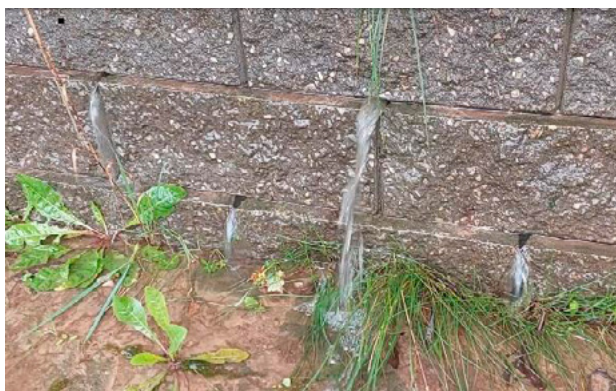
Mur wzdłuż granicy z sąsiednią działką, przez który intensywnie wypływa woda po opadach deszczu (fot. K. Rosiek)
