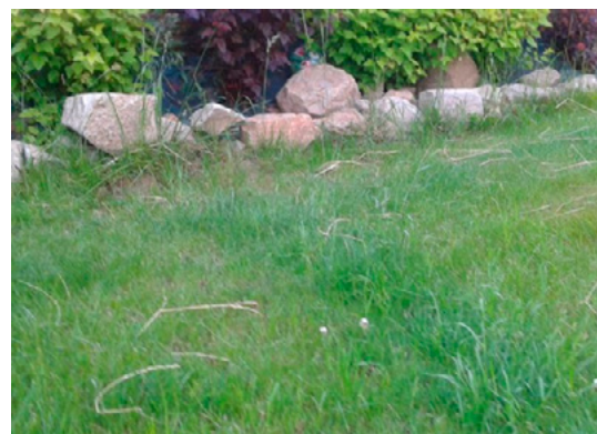
Rów chłonny przykryty darnią wzdłuż linii ogrodzenia (dobrze podlana trawa ma intensywniejszy kolor) (fot. K. Rosiek)
