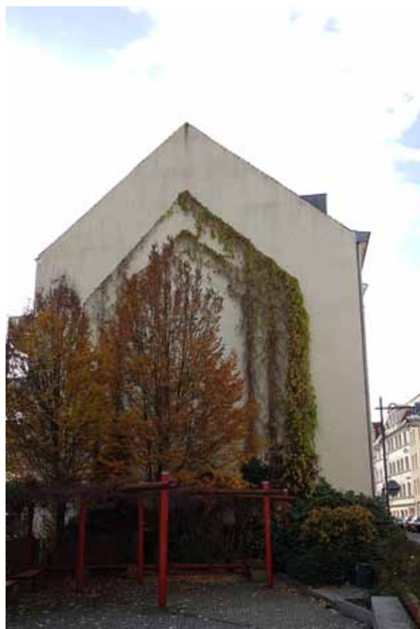
Zielona ściana prowadzona na podciągach
